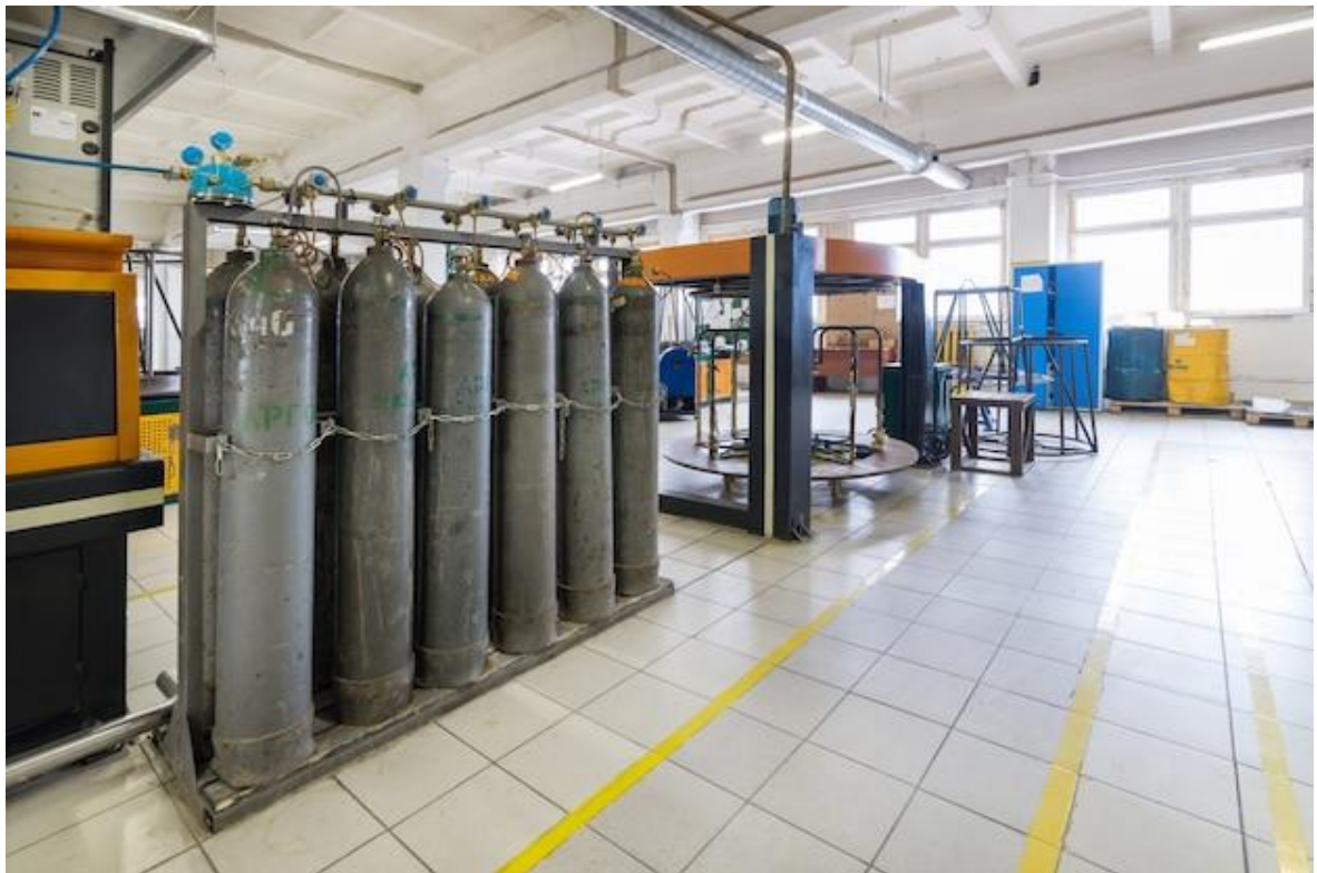
ภาพที่ 3 ตัวอย่างการจัดเก็บถังก๊าซไว้ในอาคาร
